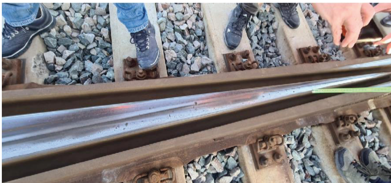
Slika 4. Kombinovani defekt (corrugation i Belgrospi) u zoni srca skretnice na železničkoj pruzi Beograd-Noví Sad
